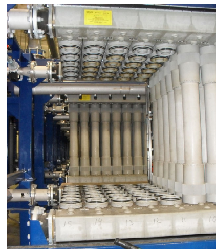
Membrane Module Replacement
