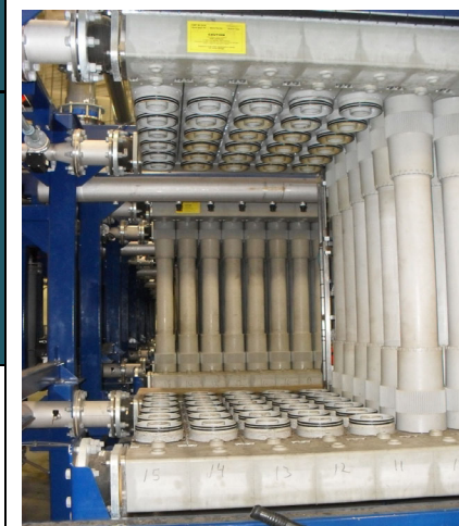
Membrane Module Replacement
