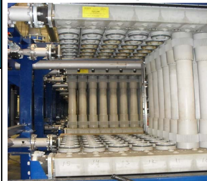
Membrane Module Replacement
